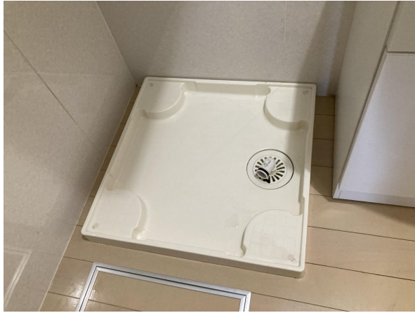
8.洗濯機防水パン
